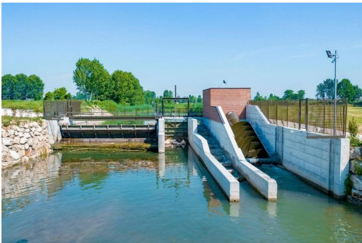
La nuova centralina sul fiume Gambara (BS) . La turbina ha una potenza massima di 100 kw.
